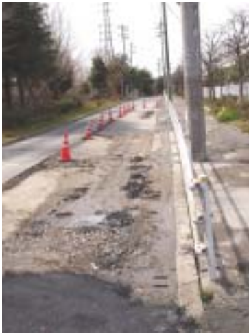
(左) 市道の破壊状況)
